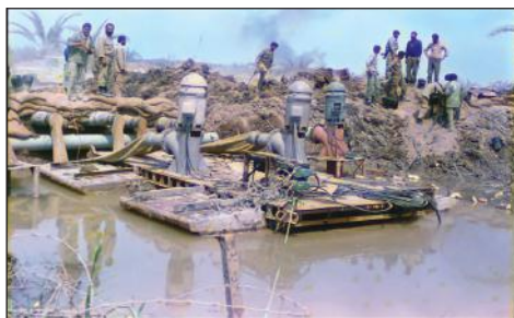
ایستگاه پمپاژ و کانالهای انتقال آب
